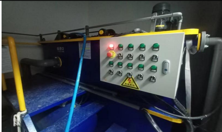
厂区污水处理设施（加盖密闭）
