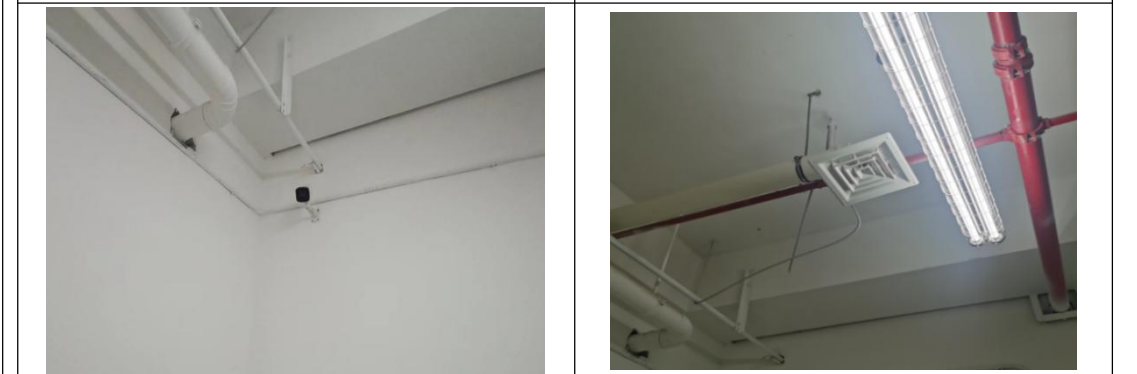
危废暂存间监控设施
